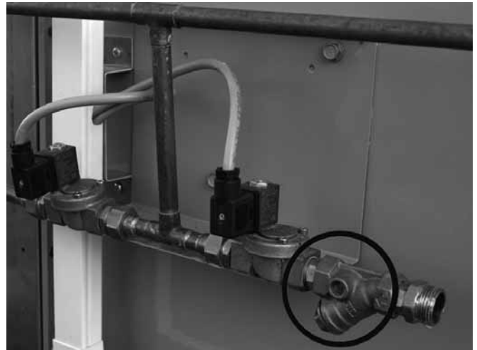
Figure 3: Filtre à eau
