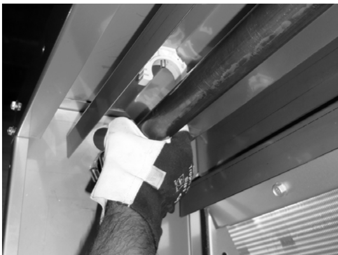
Figure 8: Libération du collecteur en cuivre des supports en plastique
