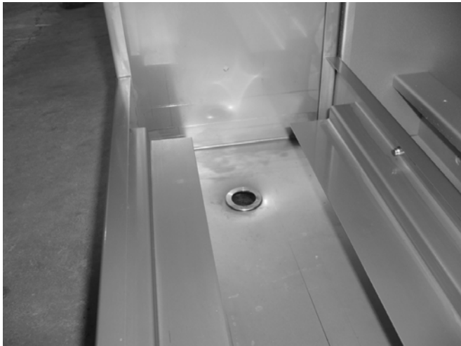
Figure 22: Système de vidange - intérieur
