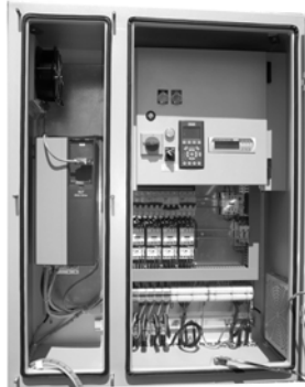
Figure 2: Coffret de commande avec variateur de fréquence
