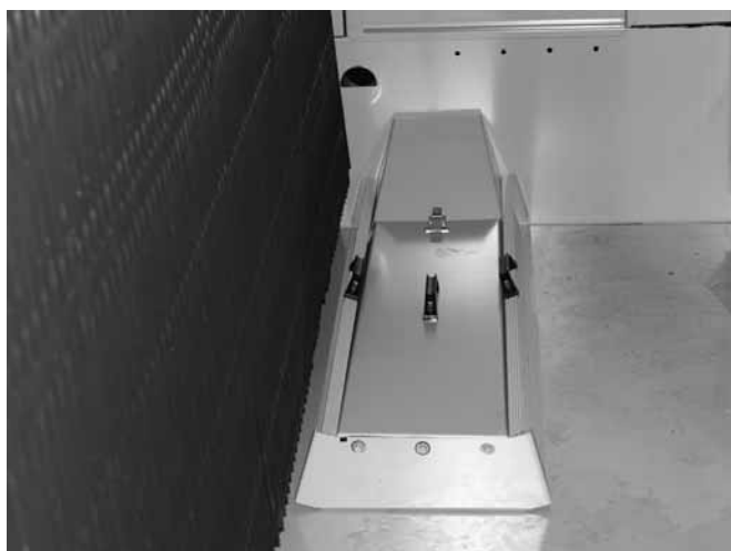
Figure 1: Bassin d'eau froide et filtre du bassin
