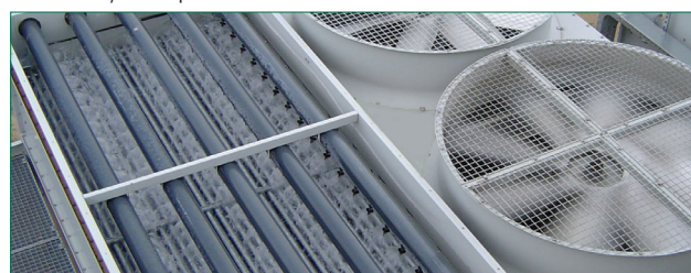
Plein accès au système de pulvérisation et au sommet de la batterie durant le fonctionnement
